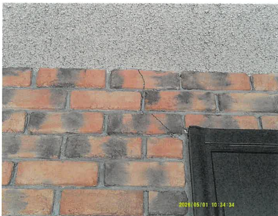
⑭ 玄関付近の外壁のひび割れの状況
