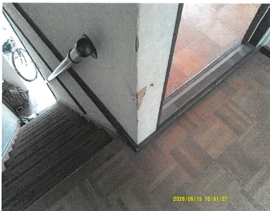
⑨ 内壁クロスのきずの状況
