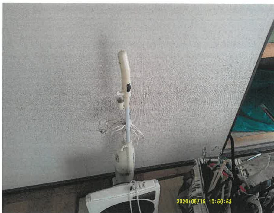
⑩ 内壁クロスのきずの状況
