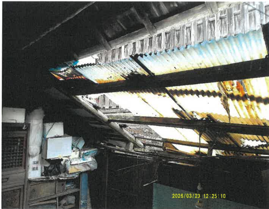
⑪ 増築部分の波板の破損状況
