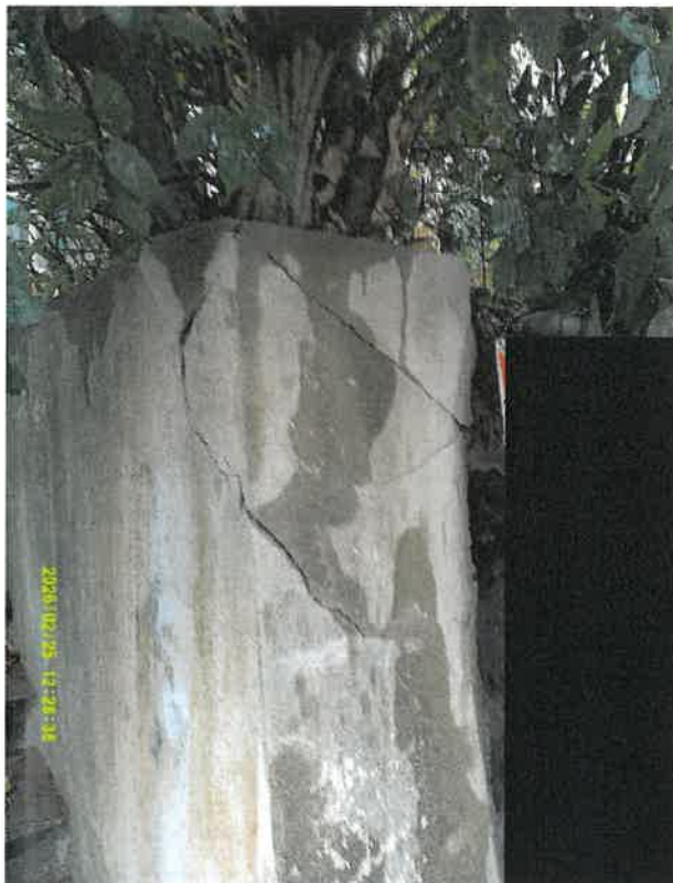
⑫ 西側道路の擁壁のひび割れの状況
