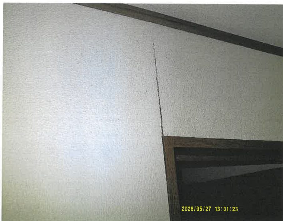
⑬ 3階廊下の内壁のひび割れ
