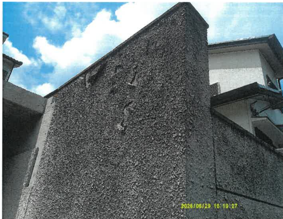
⑧ 外壁の剥がれ
