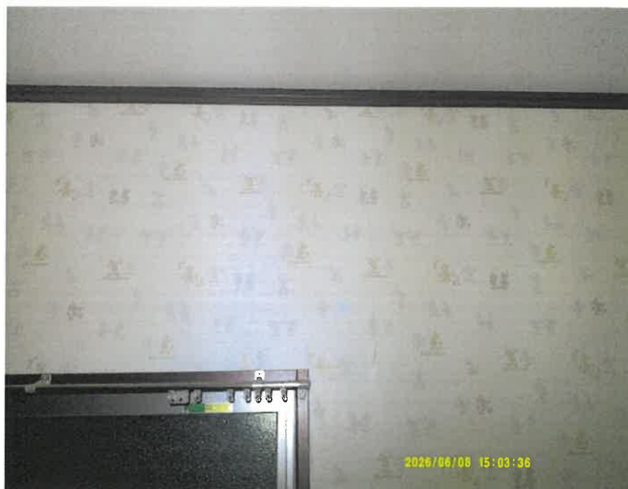
⑪ 2階北西側洋室の内壁のひび割れ
