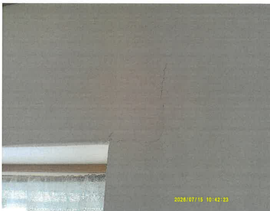
⑩ 3階内壁のひび割れ
