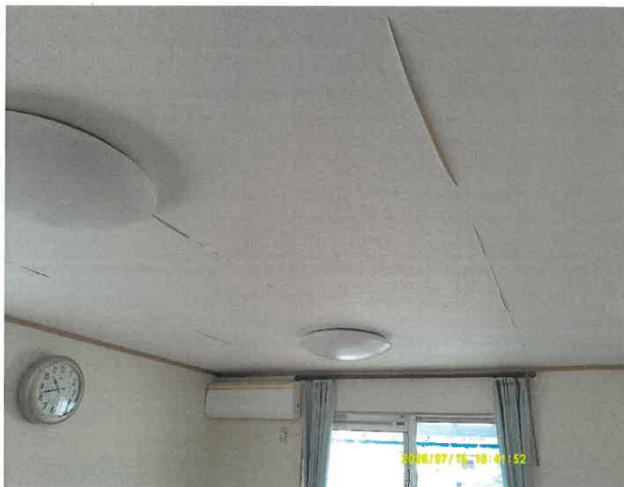
⑨ 3階洋室天井のクロスの剥がれ
