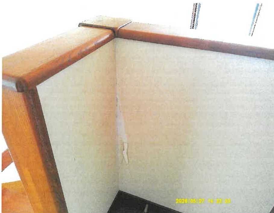
⑫ 内壁クロスのきずの状況（2階）
