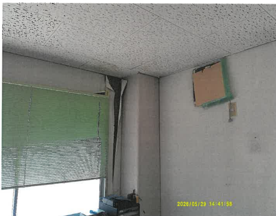
⑪ 2階事務室の内壁クロスの破損状況
