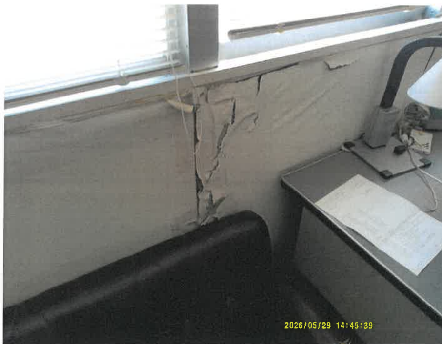
⑬ 2階南東側事務室の内壁クロスの破損状況
