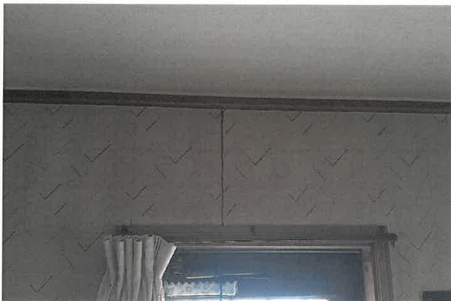
⑪ 居宅（2階西側キッチンのひび割れの状況）
