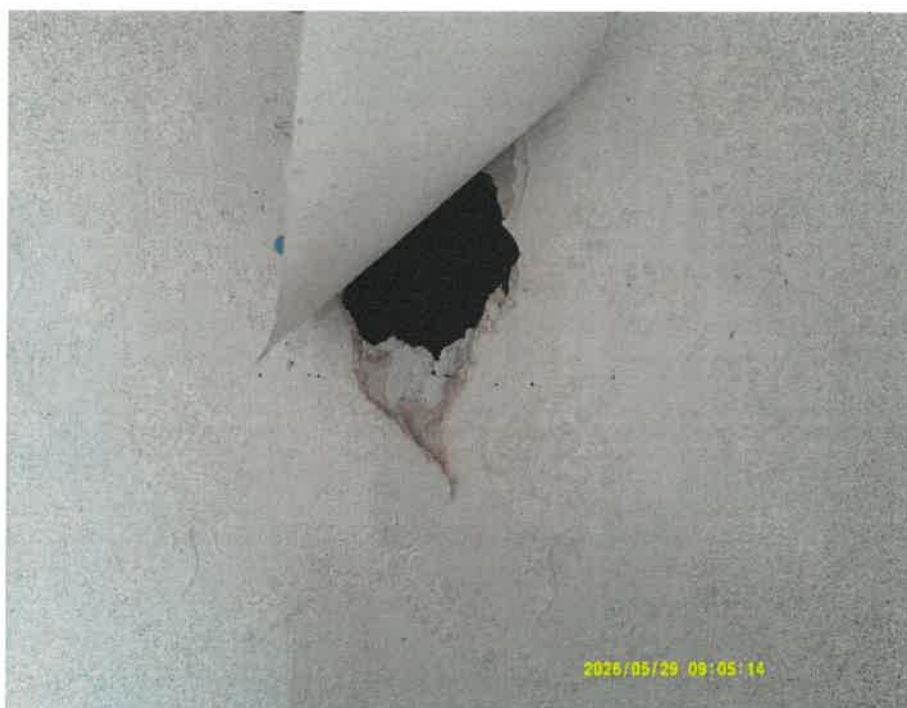
②① 居宅（3階東側洋室の壁面の破損状況）
