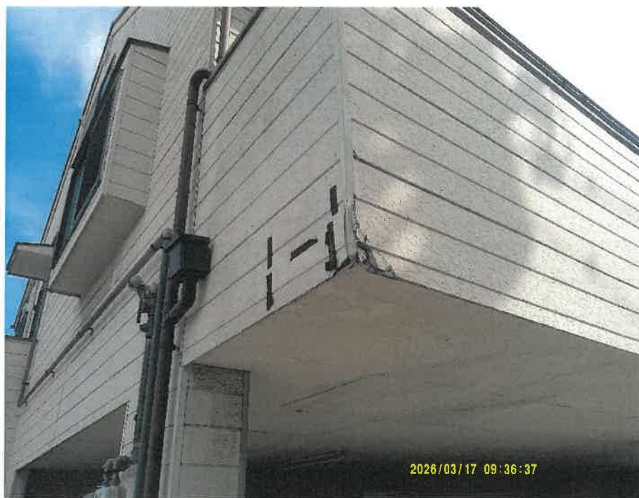
②⑦ 南西側外壁の破損状況
