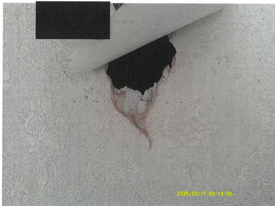
②① 居宅（3階東側洋室の壁面の破損状況）
