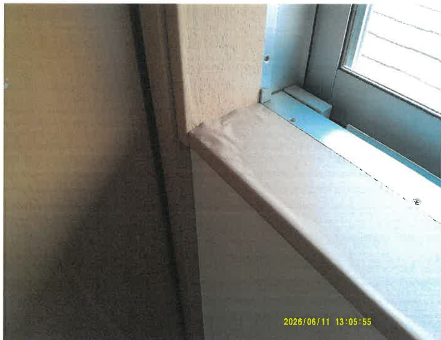
⑫ 3階西側洋室の窓枠付近の状況
