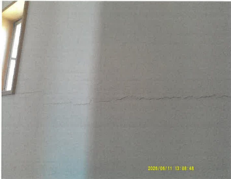
⑪ 2階と3階の間の階段の内壁のひび割れ
