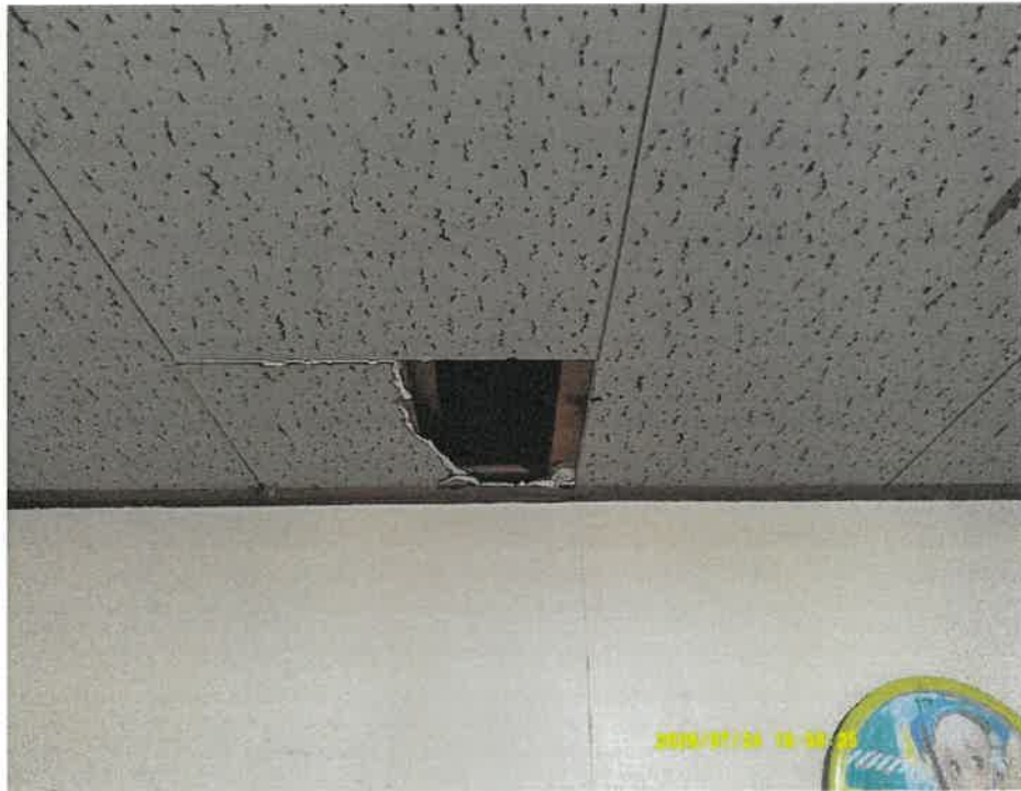
⑨ DKの天井の破損状況
