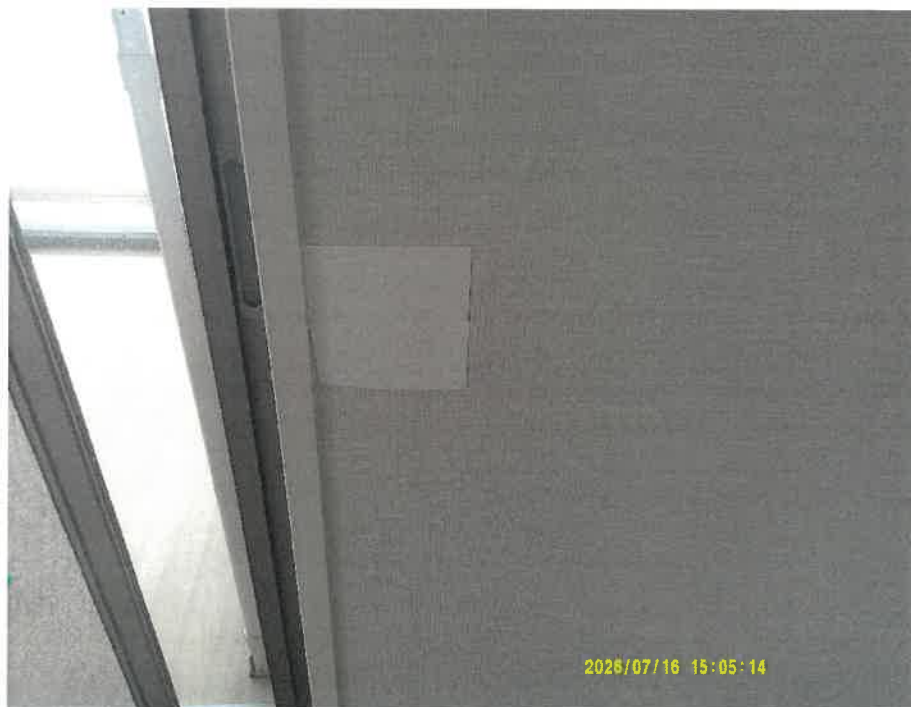
⑨ LD西隣洋室の内壁クロス補修跡
