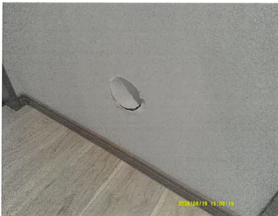
⑪ 2階廊下の壁の破損状況
