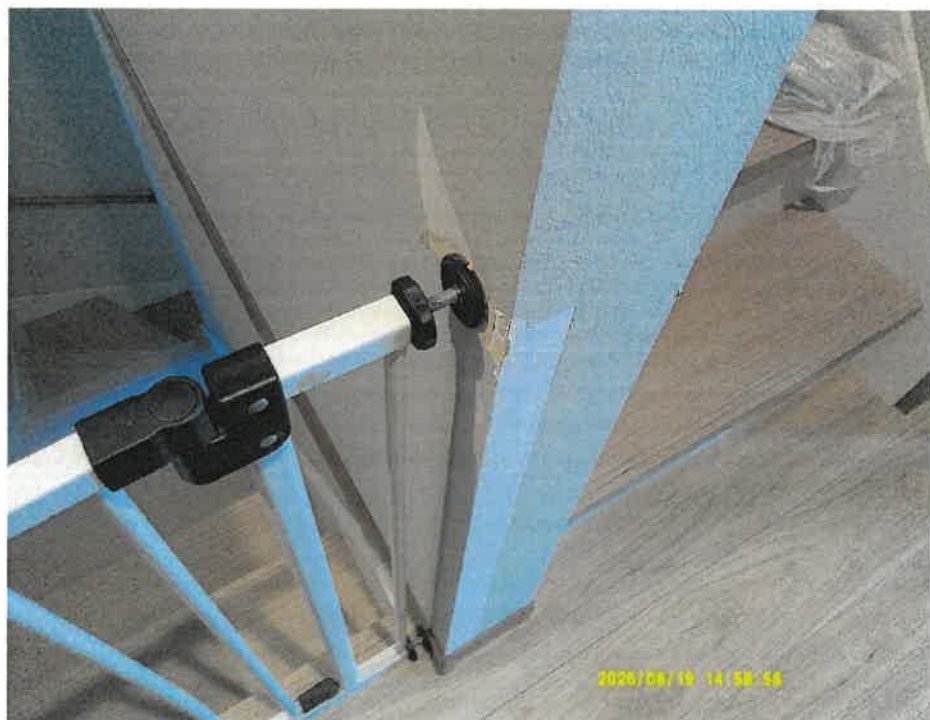
⑯ 2階階段付近のクロスの破損状況
