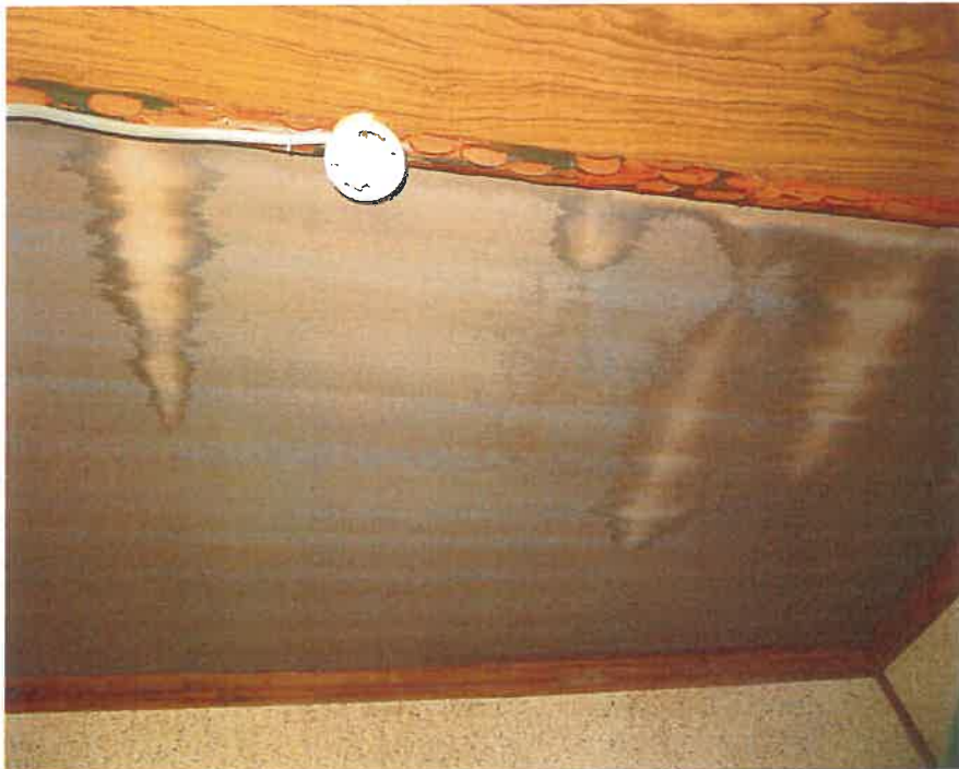
雨漏り跡のシミ
