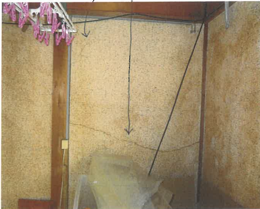
壁にある亀裂
