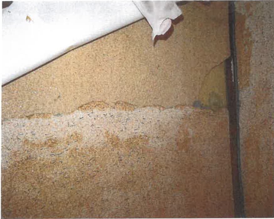
⑥のカバーの下の壁の損傷部分
