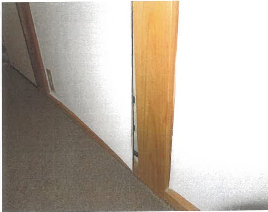
壁のクロスの浮き
