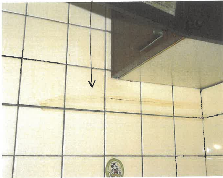
壁のタイルにある亀裂
