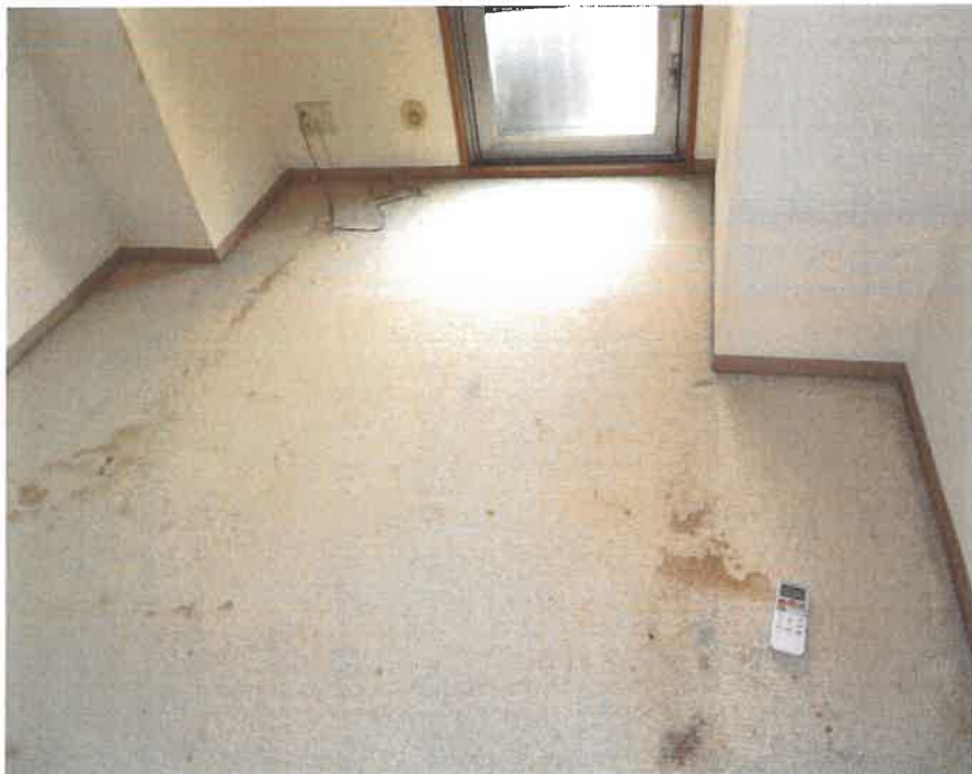
床面の全体的な汚損
