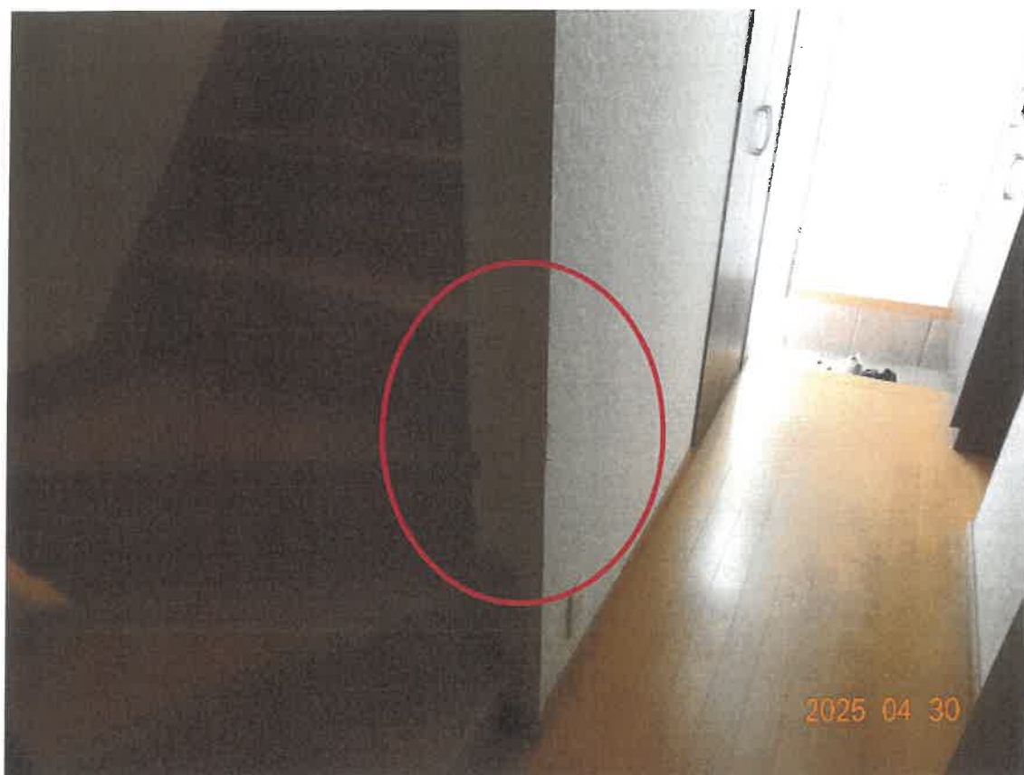
⑤ 1階壁の損傷部分
