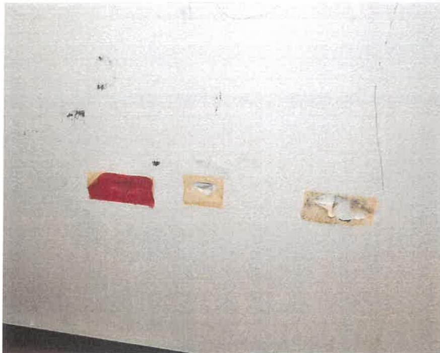
壁の損傷(3か所)
