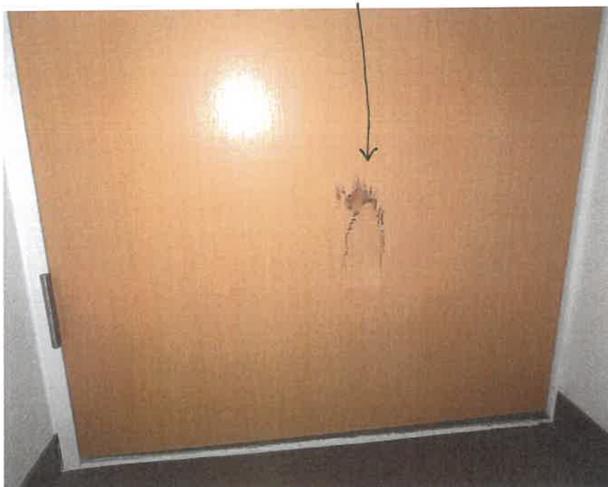
ドアにある損傷
