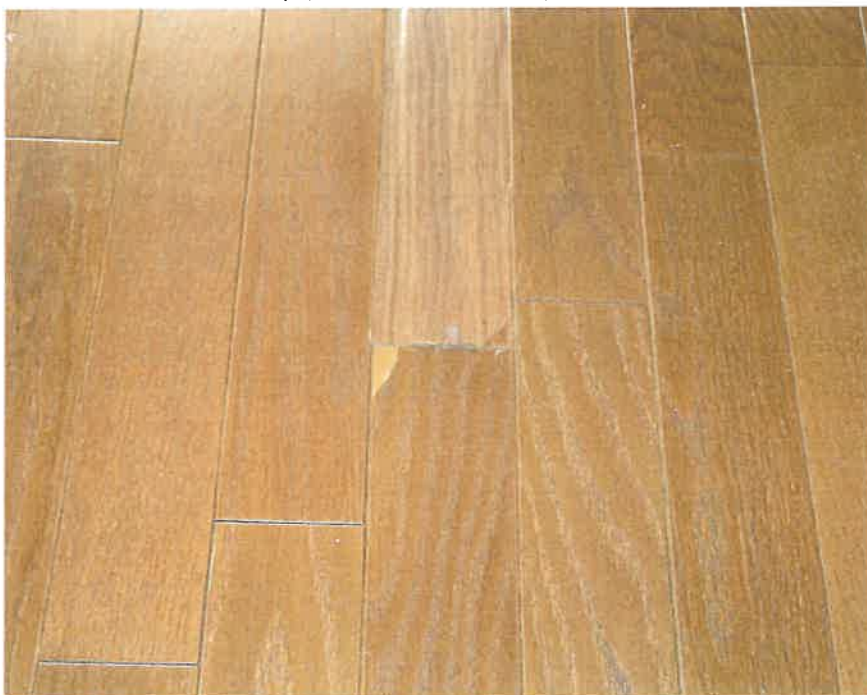
床(フローリング)の損傷
