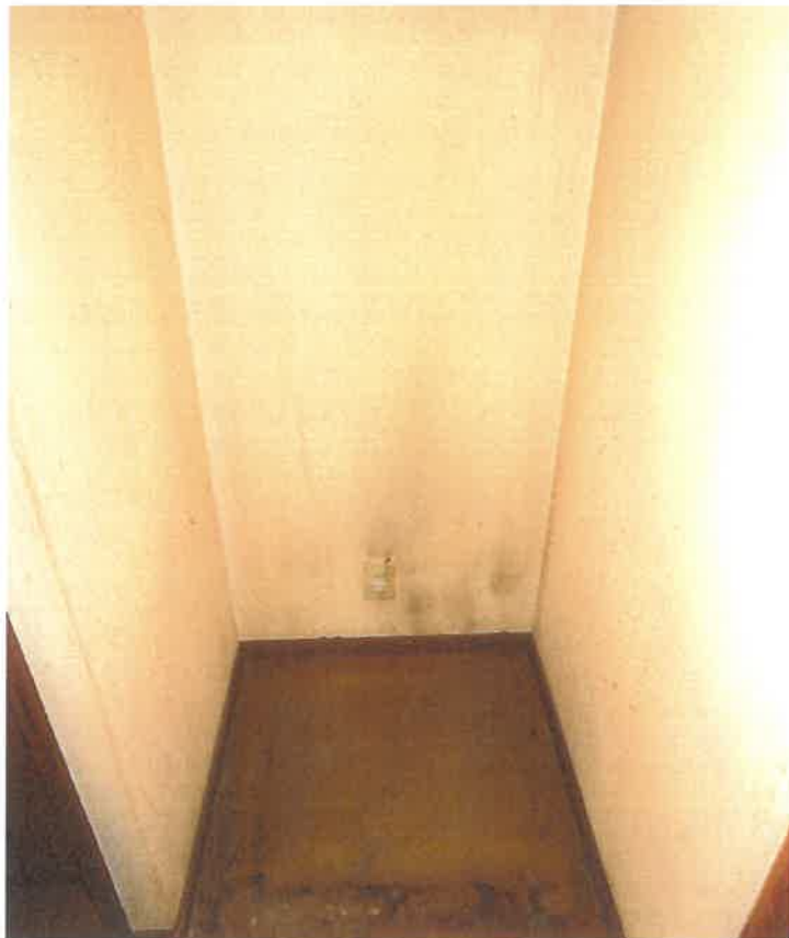
冷蔵庫置場と思われる部分の壁や床の汚れ
