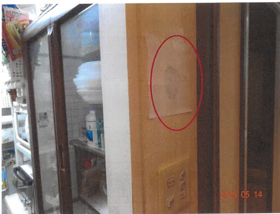
⑤ 壁の損傷部分
