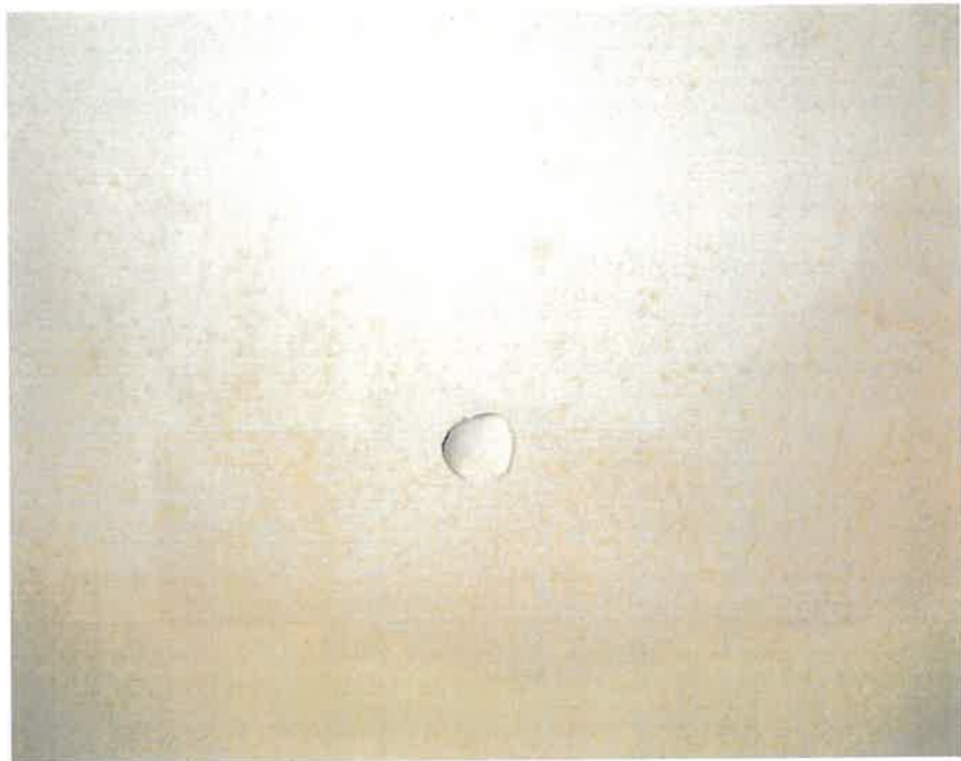
壁にある陥没したような損傷
