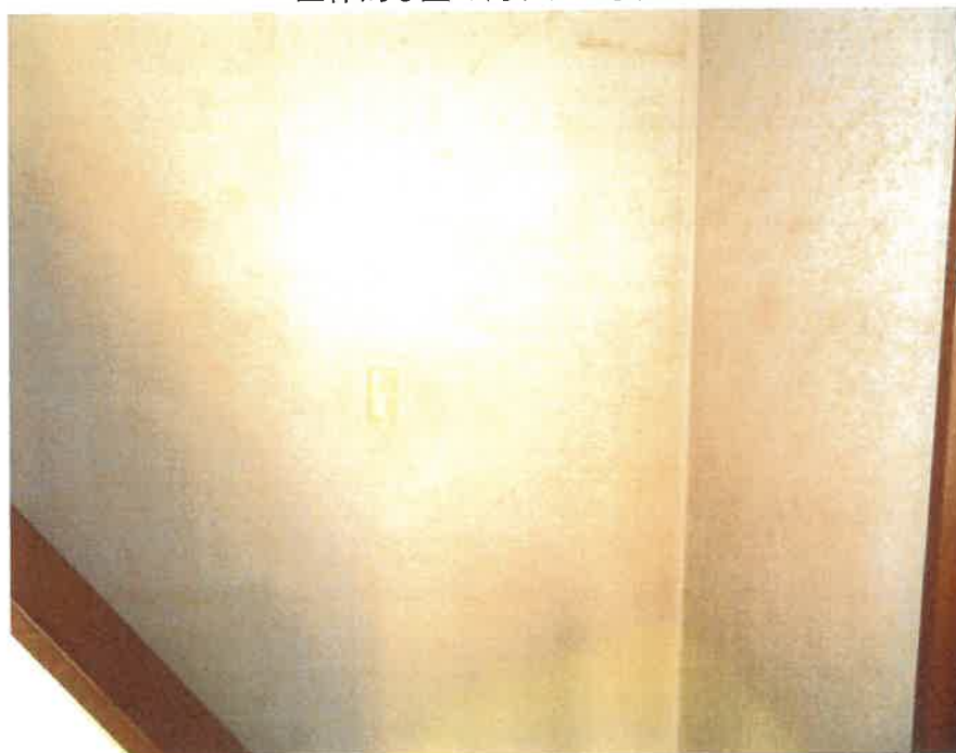
全体的な壁の汚れ又は変色
