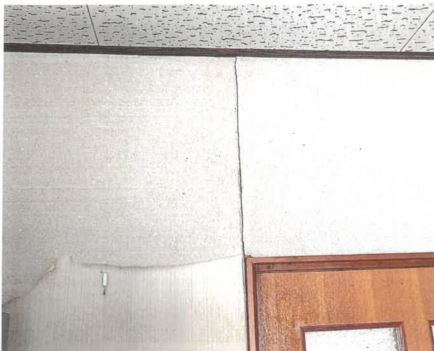
内壁クロスの剥がれと亀裂
