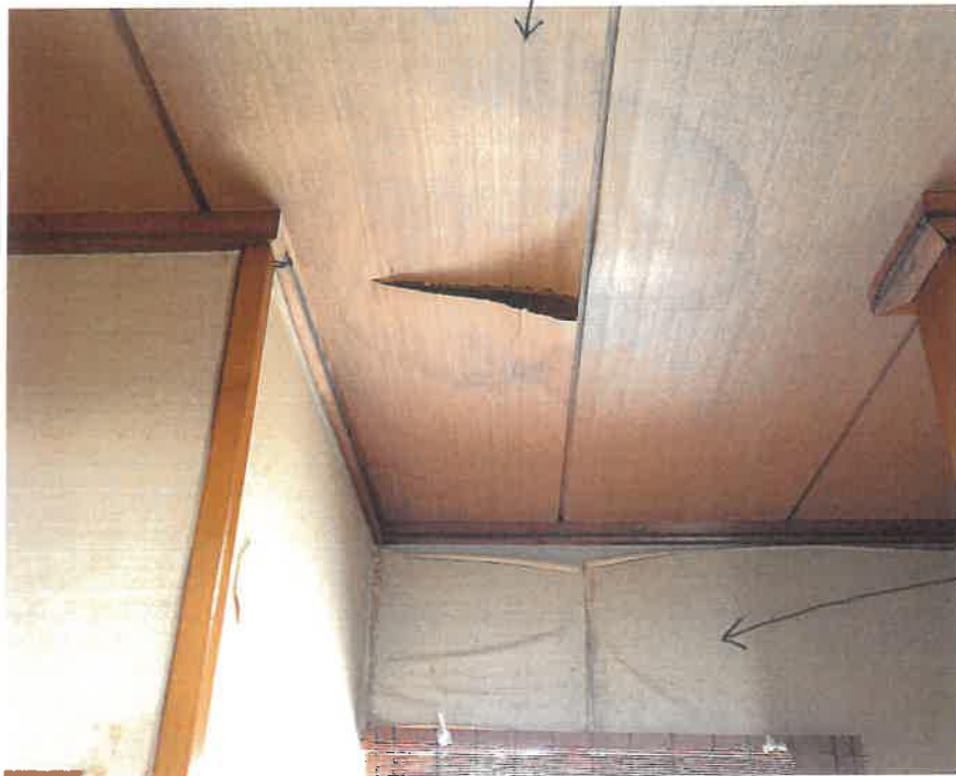
天井の破損と雨漏り跡のようなシミ
