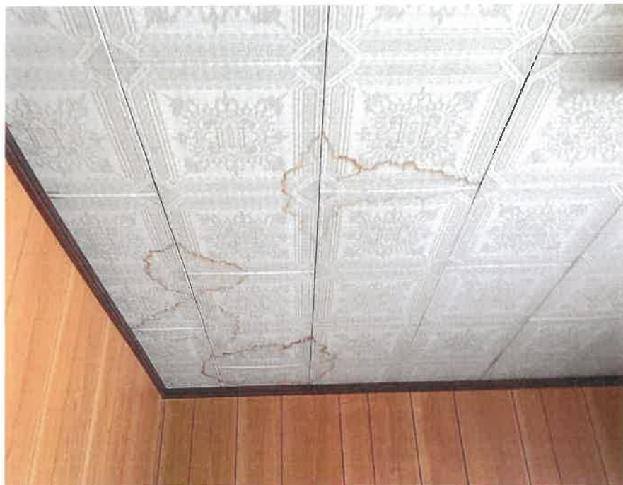
天井にある雨漏り跡のようなシミ
