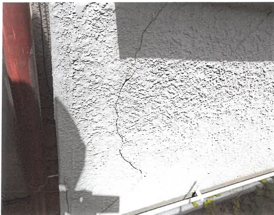
目的建物の外壁にある亀裂
