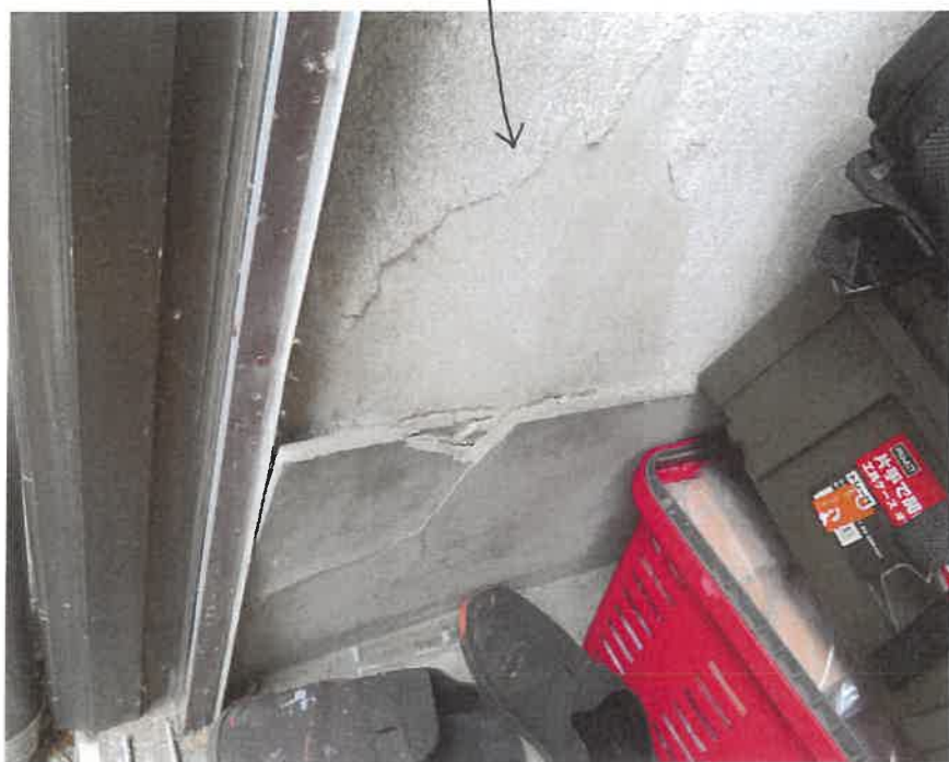
玄関横の内壁の損傷
