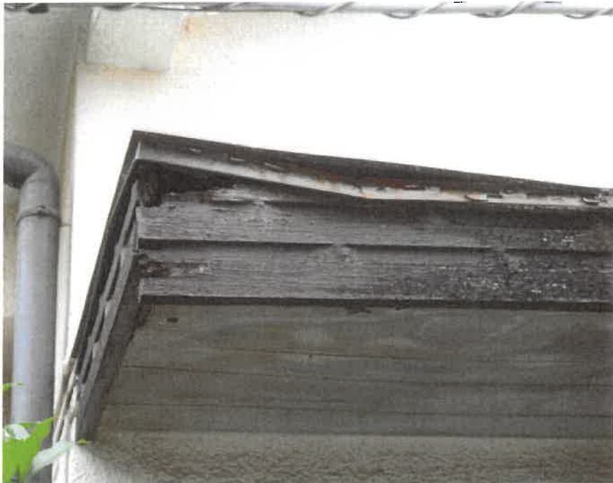
玄関前の軒先の損傷
