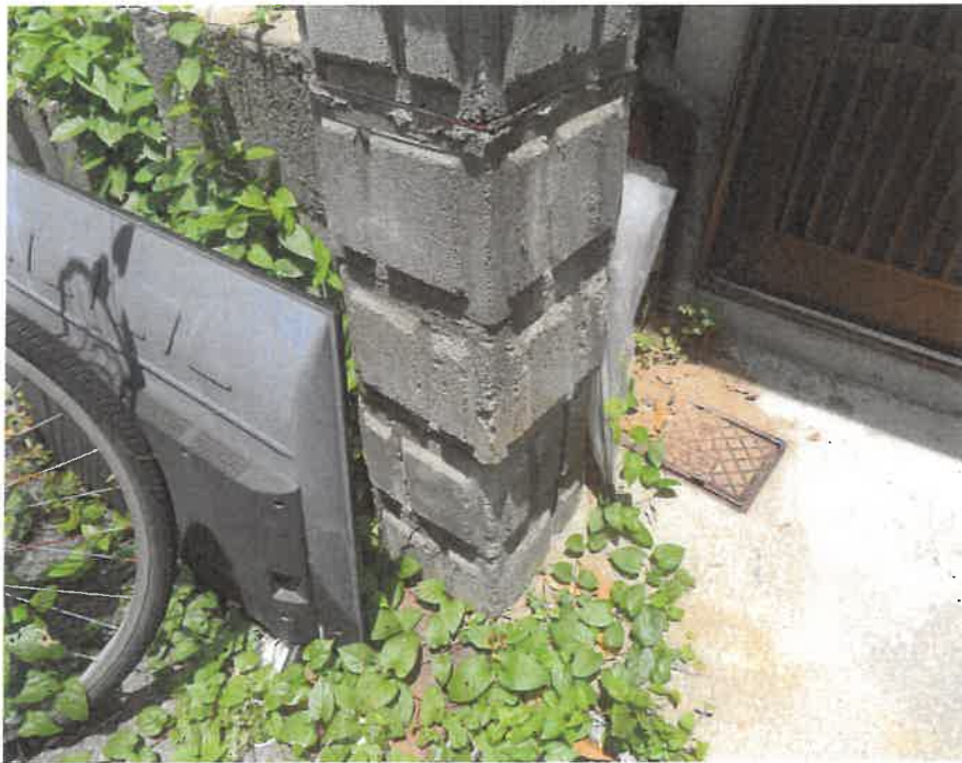
花壇部分角のブロックのズレや亀裂
