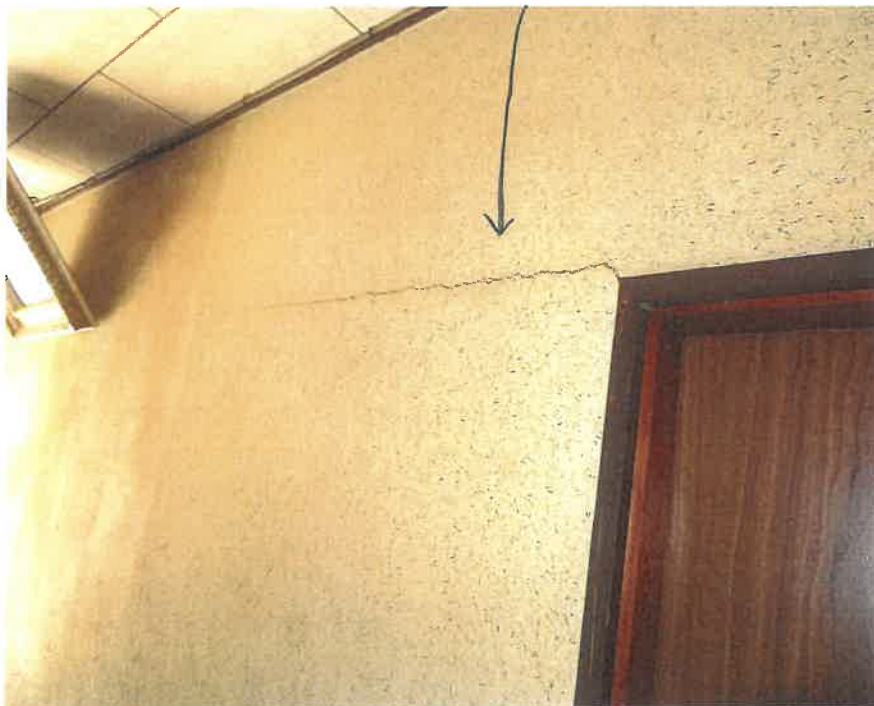
内壁にある亀裂
