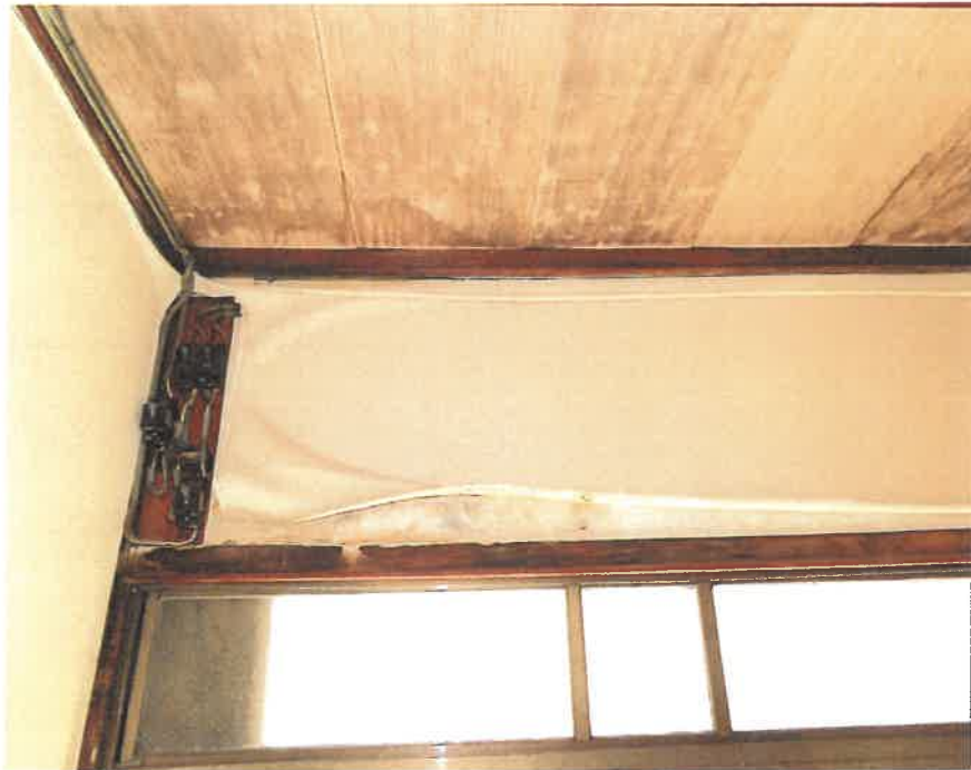
天井付近の壁紙の剥離と天井の変色
