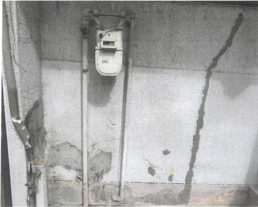
外壁の損傷や補修跡
