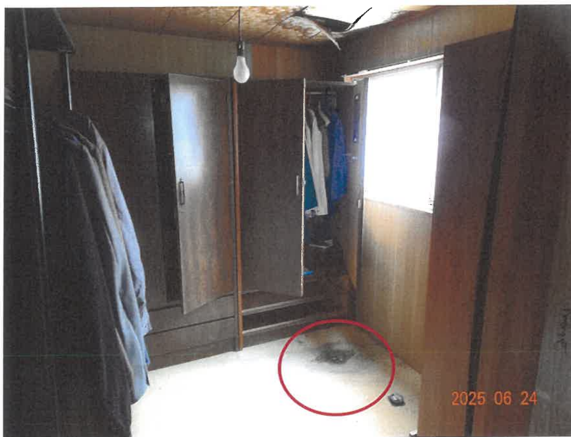
⑦雨漏りによるものと推測される破損部分
