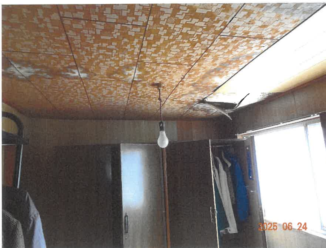
⑧雨漏りによるものと推測される天井の破損部分
