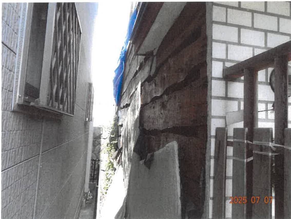
④ 外壁の損傷部分
