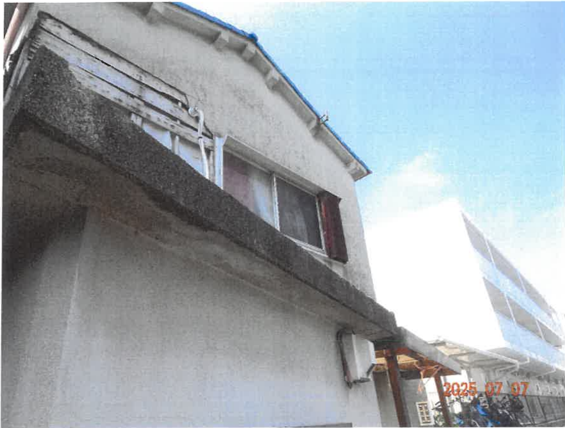
⑤外壁の損傷部分
