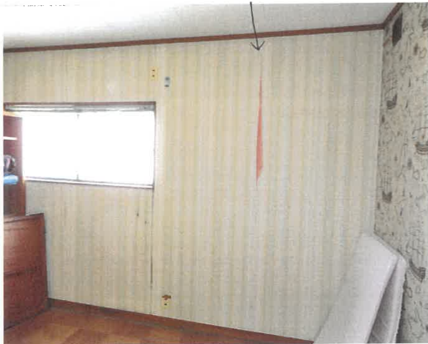
クロスの剥離(窓下付近にもある)
