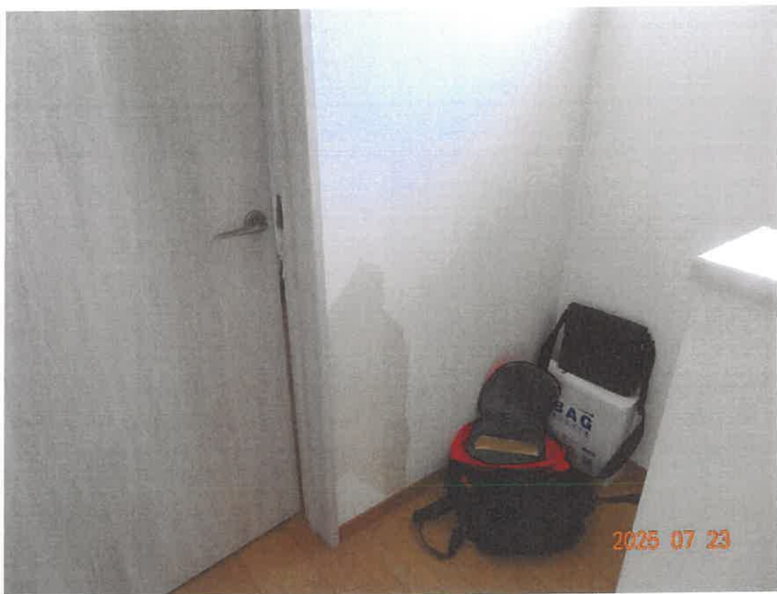
⑨ 2階廊下の壁紙の剥がれ
