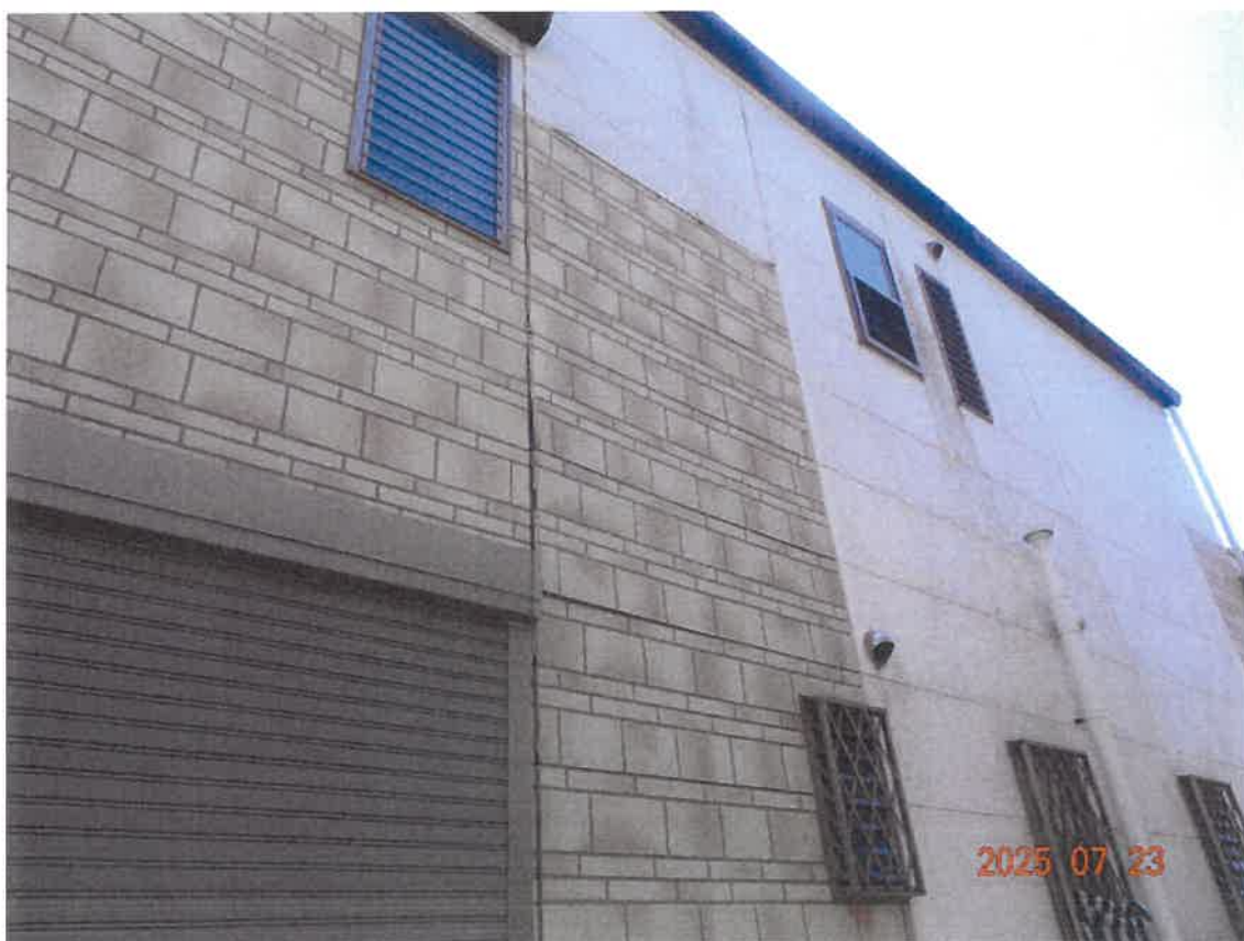
② 外壁の剥離部分
