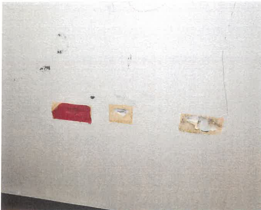
壁の損傷(3か所)
