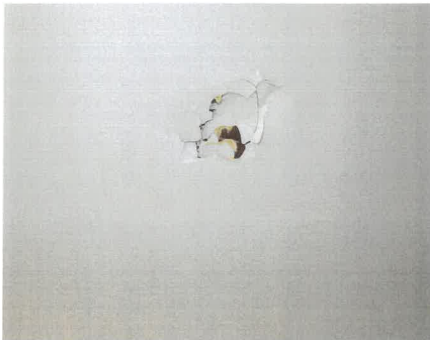
ドアにある損傷
