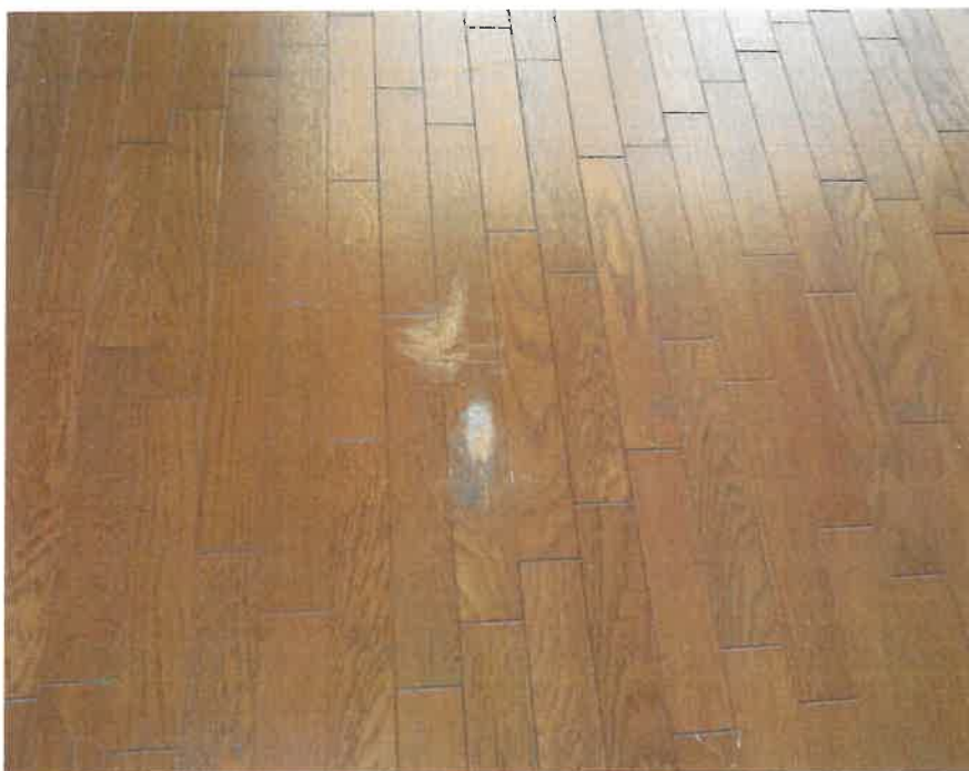
床(フローリング)の損傷
