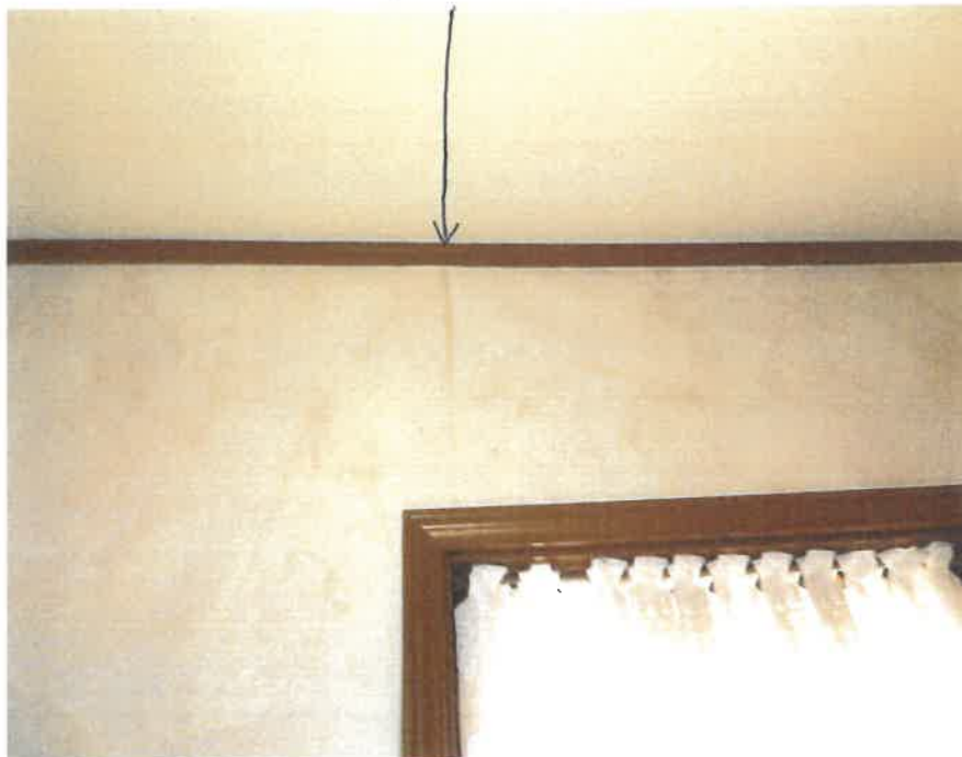
天井付近の壁のクロスの剥離
