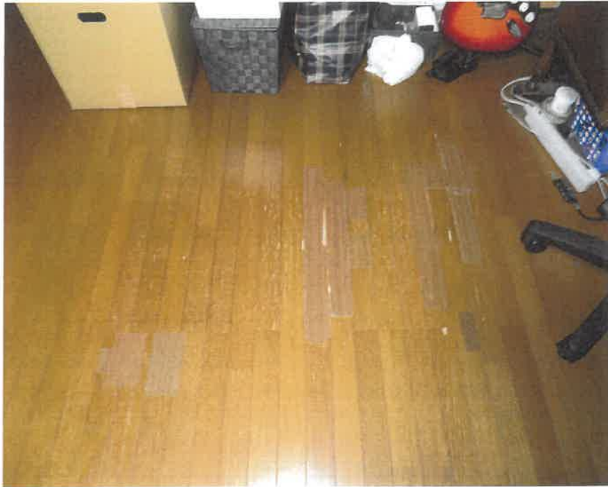
床面(フローリング)の損傷
