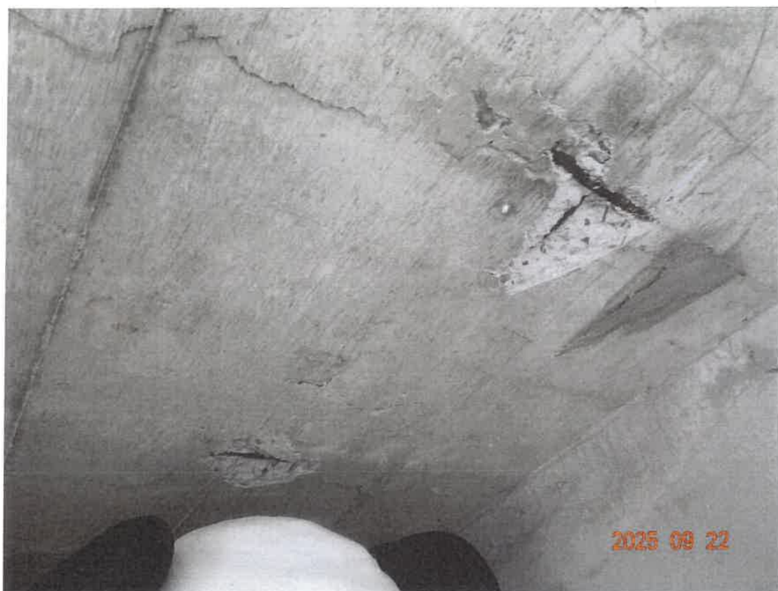
③車庫天井のコンクリートの剥離
