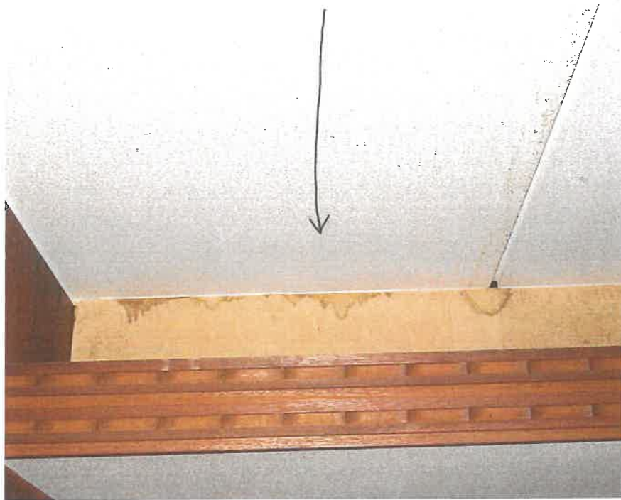
天井付近の雨漏り跡のようなシミ
