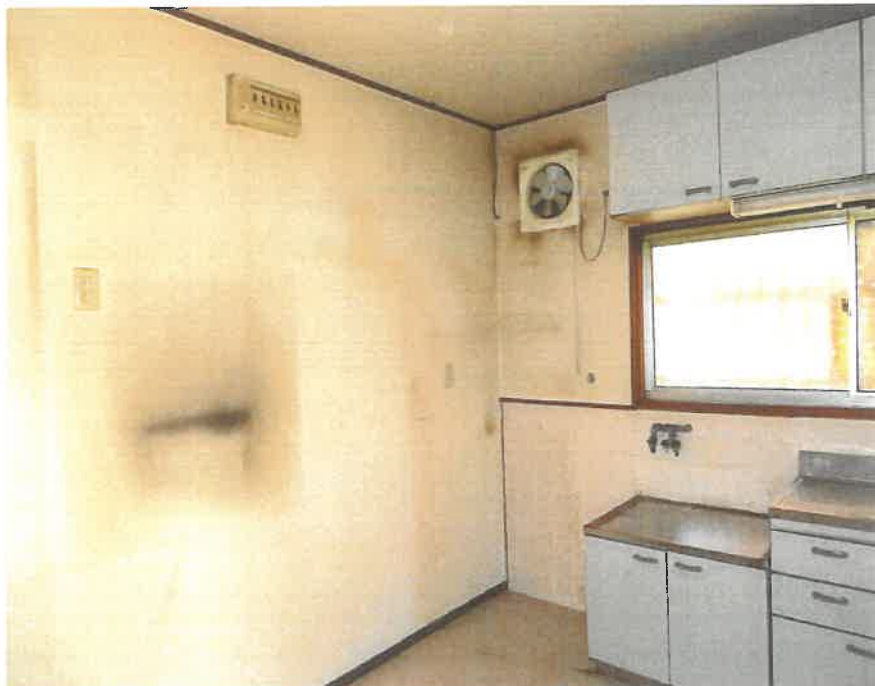
全体的な壁の汚れ
