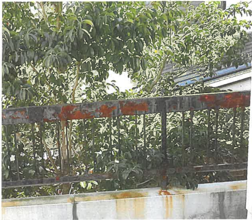
バルコニーの鉄部の腐食(錆び)
