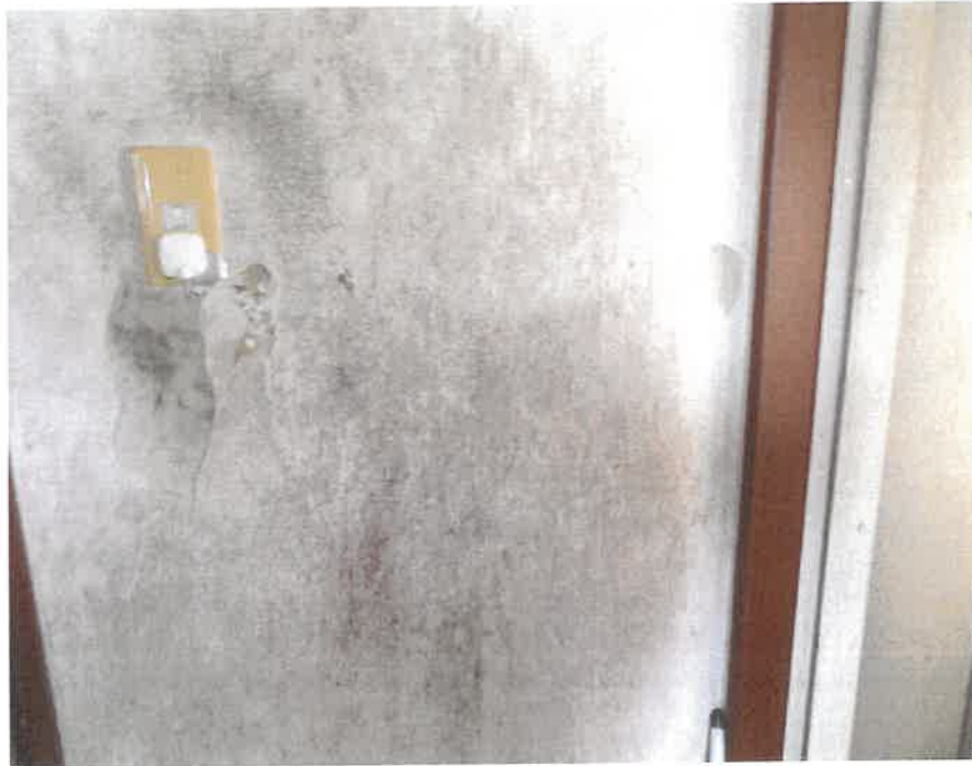
壁のカビ汚れとクロスの損傷等
