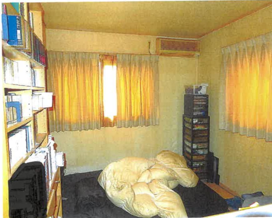
全体的に天井や壁の変色が顕著な洋室
