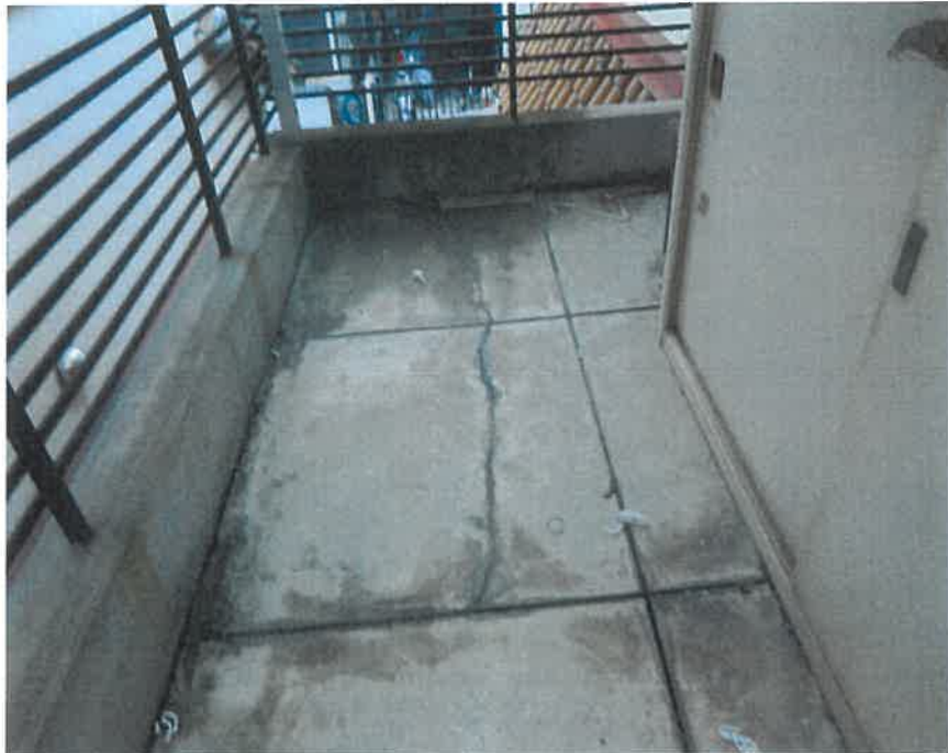
ベランダの床にある亀裂の跡
