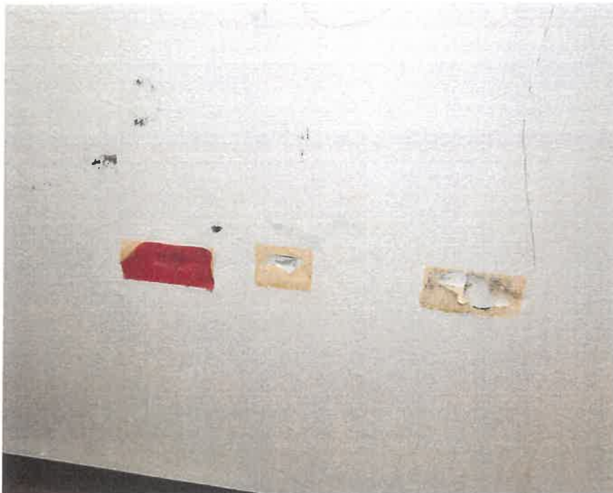
壁の損傷(3か所)
