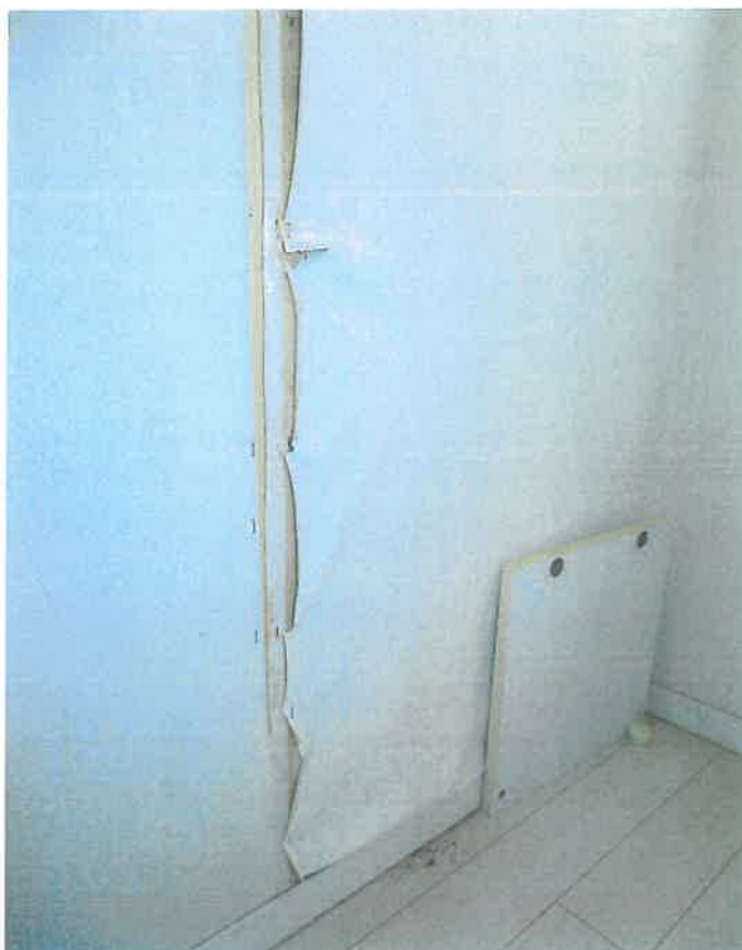
クロスの剥離
