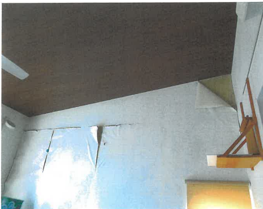
天井付近の壁クロス剥離
