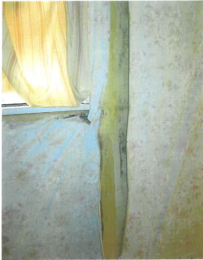
壁クロスが剥離した裂け目からむき出しの素材
