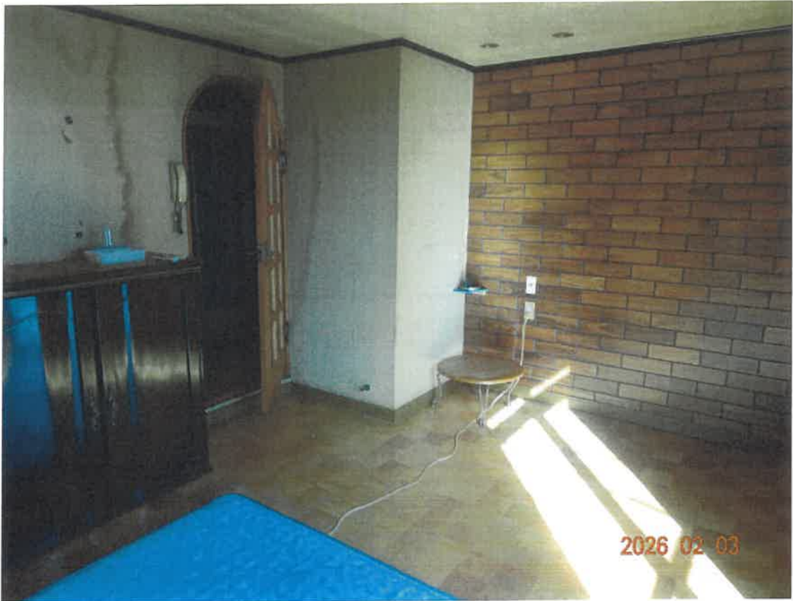
㊦ 3階南西洋室の壁のしみ
