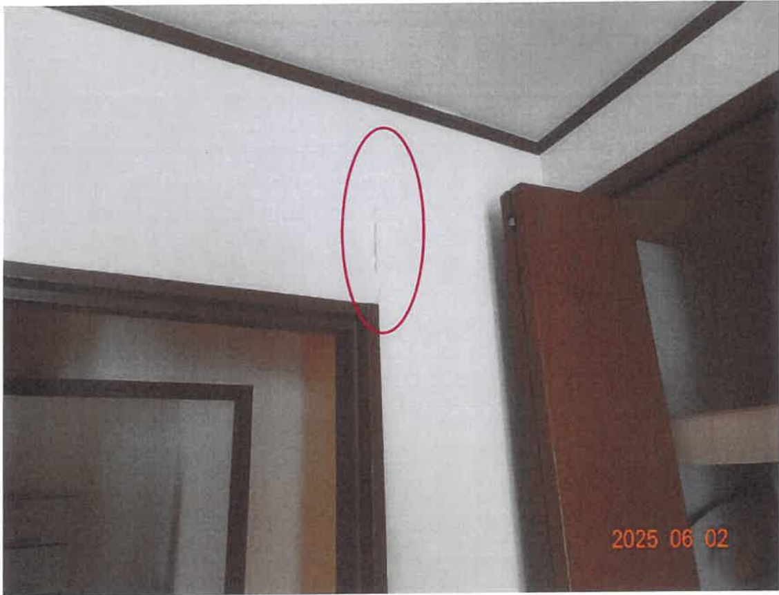
⑪ 壁のひび割れ
