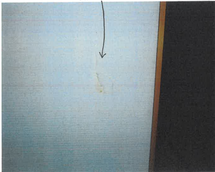
壁クロスの破損
