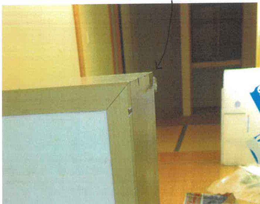
流し台側面の壁の角にある損傷
