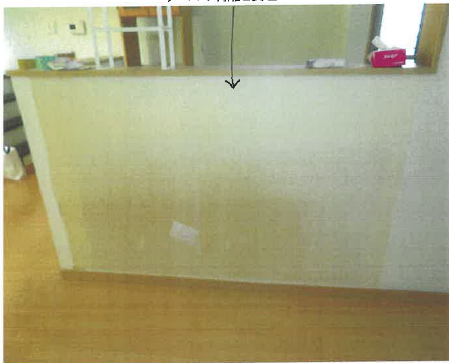
クロス剥離と変色
