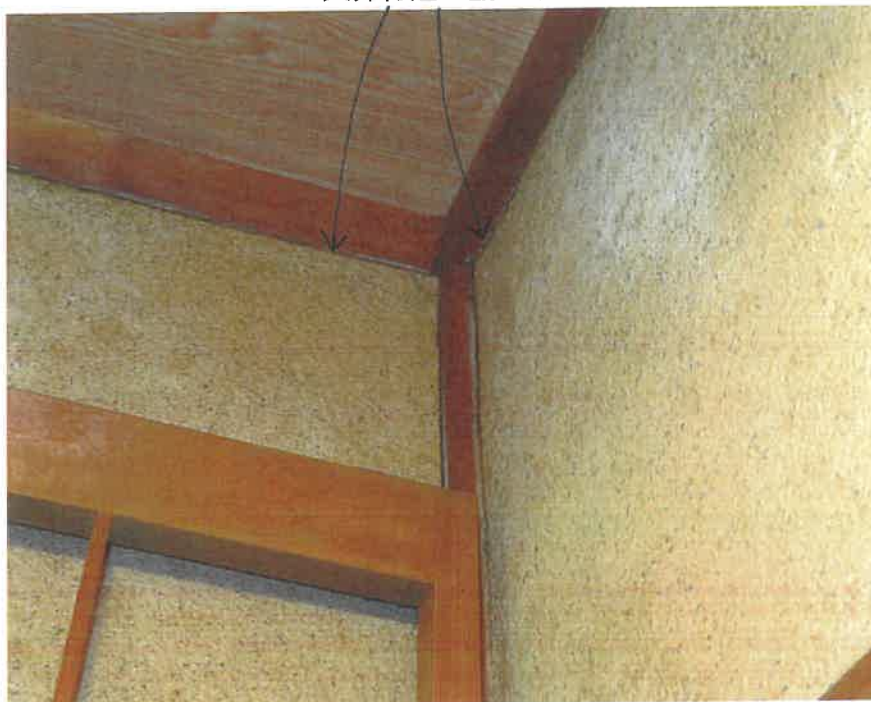
天井付近の壁にある亀裂
