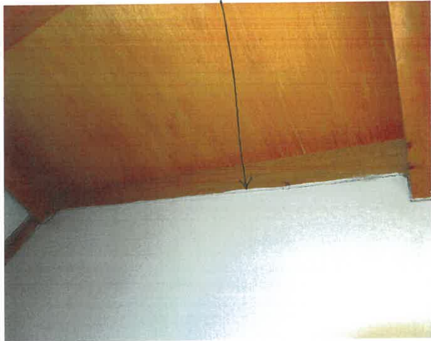
天井付近の壁にある亀裂
