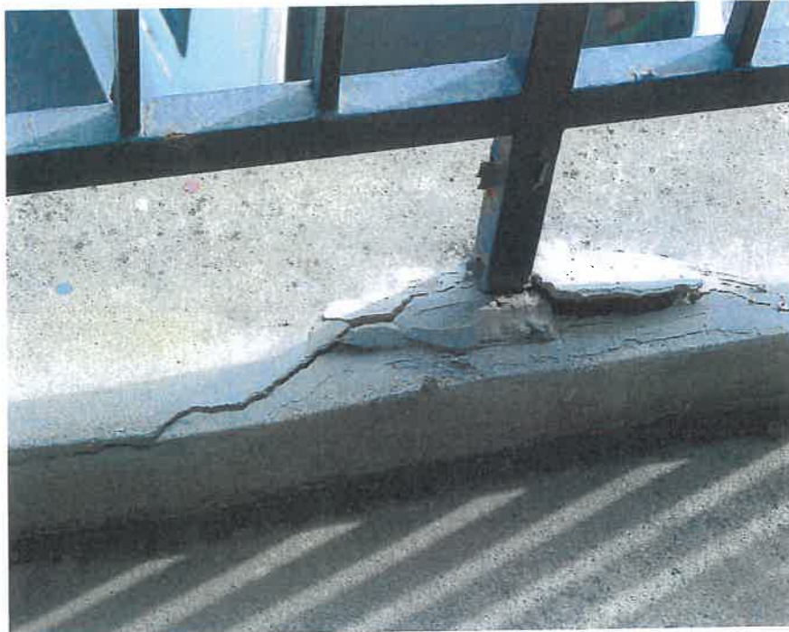
ベランダ床の縁にある損傷
