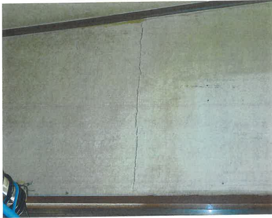
天井付近の壁にある亀裂
