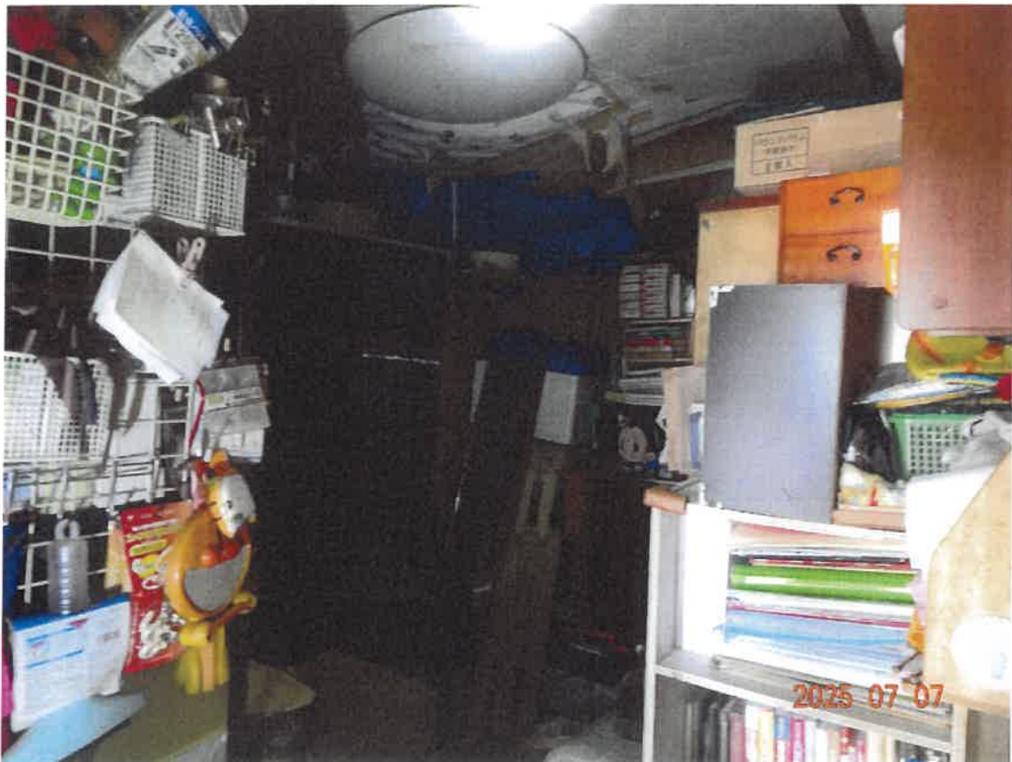
⑥1階洋室の天井から雨漏りがあると推測される部分
