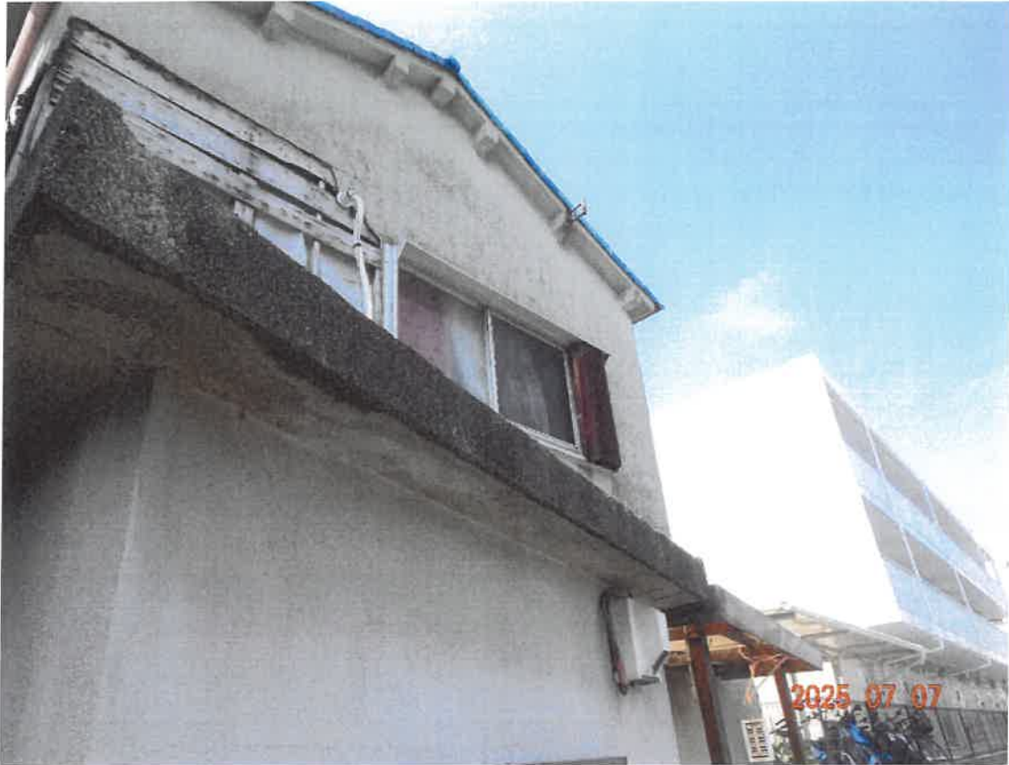
⑤外壁の損傷部分
