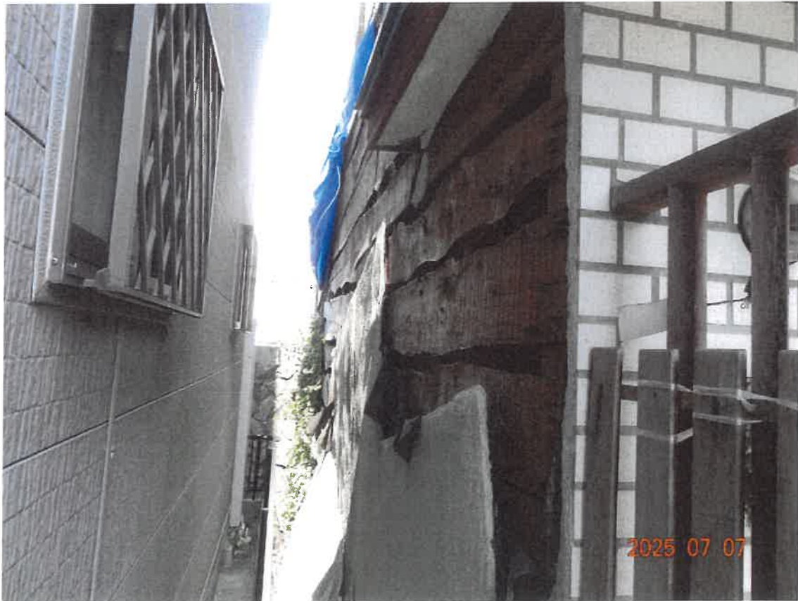
④ 外壁の損傷部分
