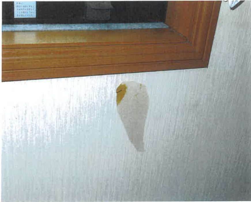
壁クロス剥離
