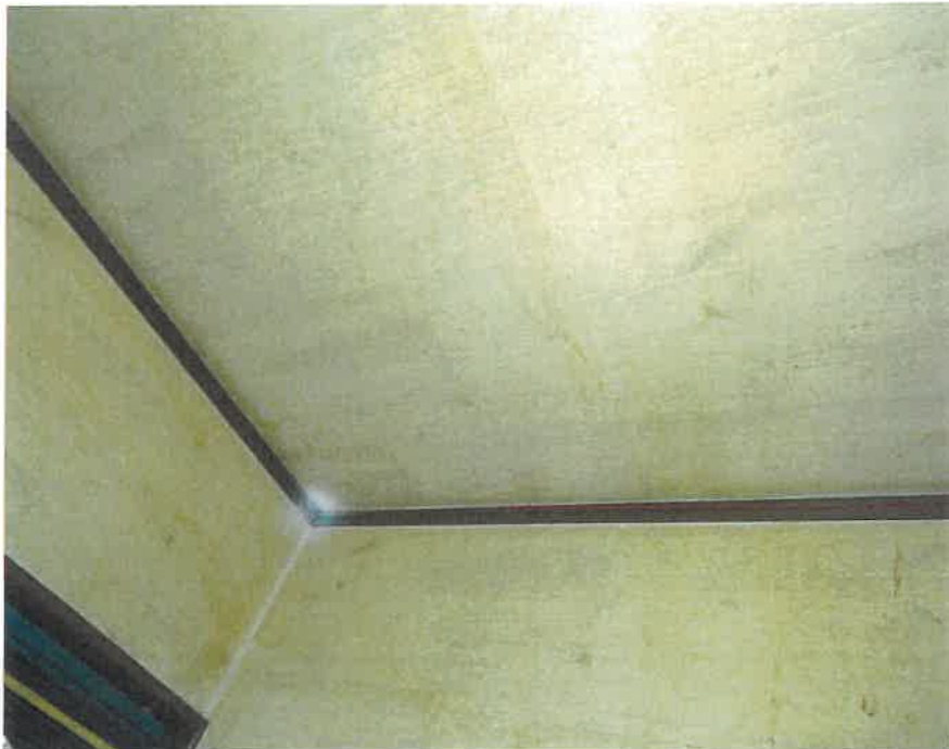
天井及び壁の黄ばみや汚れ
